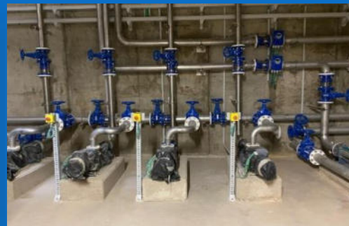
Bombeo de fangos
