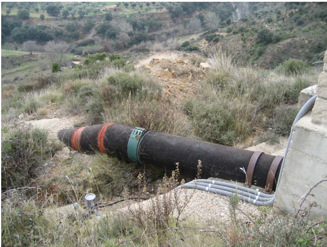
Ref. 15.- Toma intermedia de agua del río Guatzalema a su paso por la localidad de Las Almunias del Romeral para abastecimiento a Huesca: detalle de la tubería.
