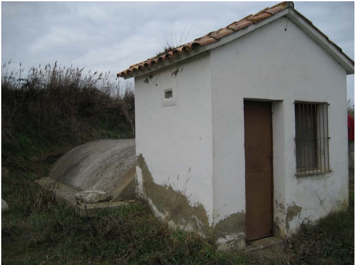
Ref. 35.- Vista de la elevación de agua para la localidad de Argavieso situada en el río Guatizalema aguas abajo de dicha localidad.
