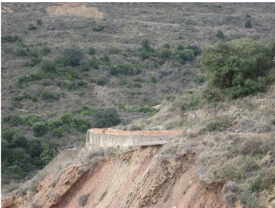
Ref. 14.- Detalle del mal estado del canal de abastecimiento a Huesca a su paso por la localidad de Las Almunias del Romeral dónde se observa que está siendo reparado en los tramos en los que se encuentra a cielo abierto.
