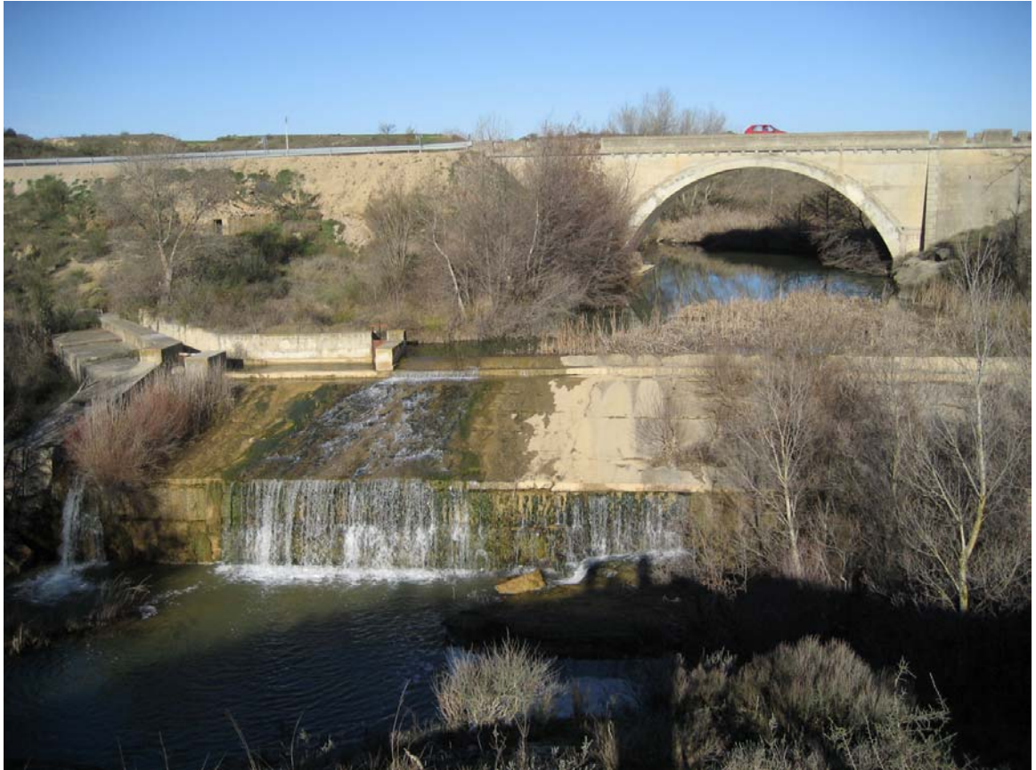
Ref. 49.- Vista general del azud situado en el río Guatizalema aguas abajo de Peralta de Alcofea que se utiliza para dar paso a la acequia de Sariñena que nace en el río Alcanadre.
