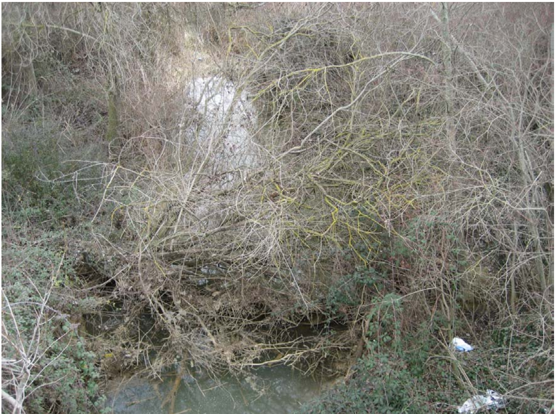
Ref. 34.- Vista de la desembocadura del río Botella en el río Guatizalema aguas abajo de la localidad de Argavieso en un tramo dónde el río necesitaría limpieza del cauce que está taponado por vegetación y limpieza de basuras y desbroce en ambas riberas.
