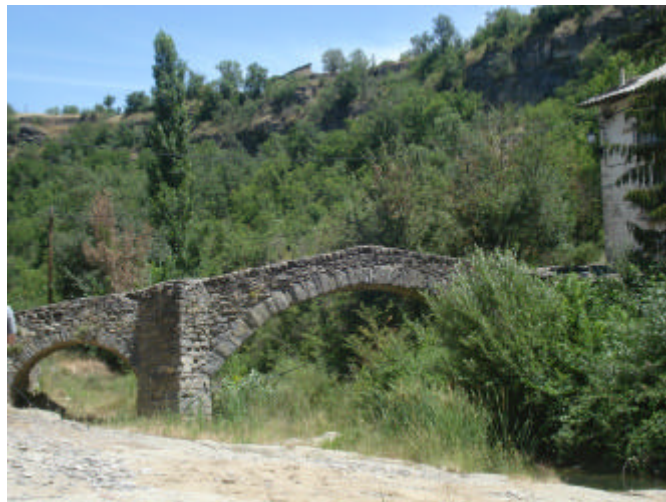
Imagen 3: Detalle de presencia abundante de vegetación en el cauce de río San Juan
