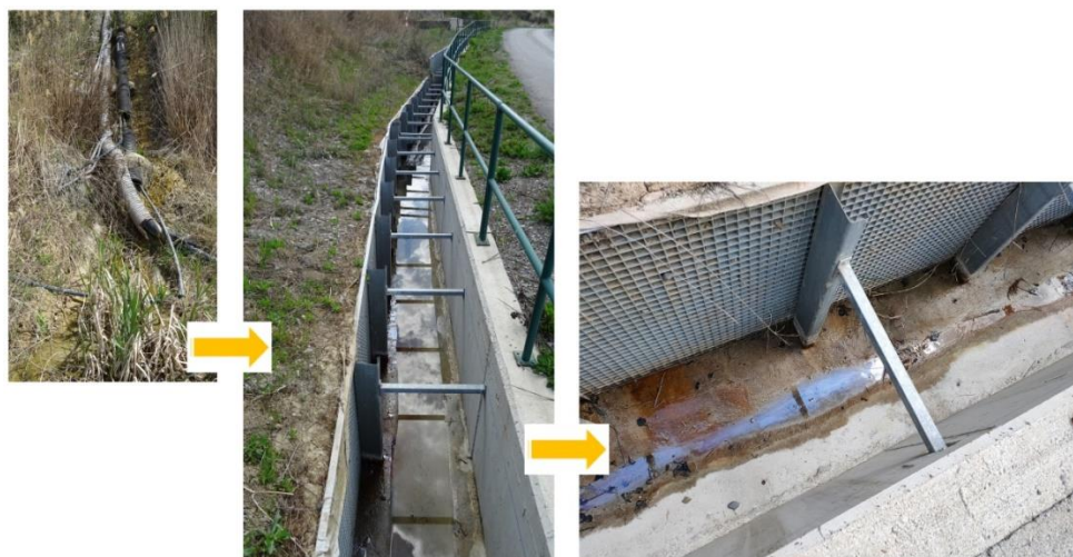
Figura A10.5. Tuberías de captación y arqueta de recogida de liviviados y escorrentías. Detalle de los liviviados
