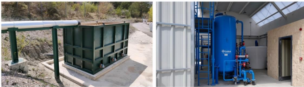
Figura A10.7. Decantador (izquierda) y planta para tratamiento de lixiviados (derecha)
