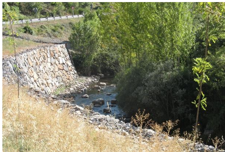
Figura 21-8. Defensas de margen en la masa de agua.
